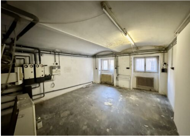
Lager/Technikraum im Zwischengeschoß
